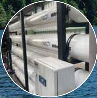
Ham Su Arıtma Sistemleri
